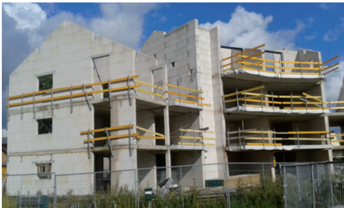
Het Hoogste Gebouw (gebouw 3) heeft bijna de top bereikt (foto eind september 2015)
